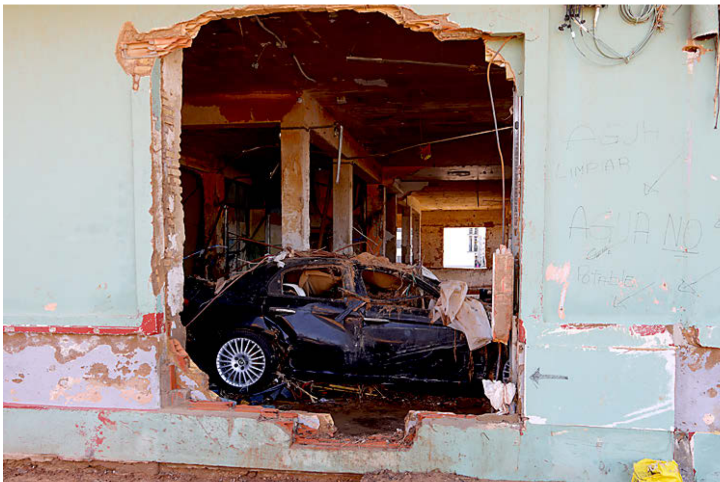
Los daños provocados por inundaciones entran dentro de la cobertura del seguro de riesgos extraordinarios del Consorcio.
